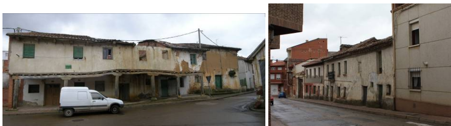
Foto 38. Edificación tradicional ruinosa.
